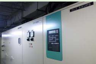
N+1で構成された無停電電源装置
