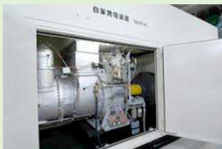
災害時60時間稼働可能な自家発電設備
