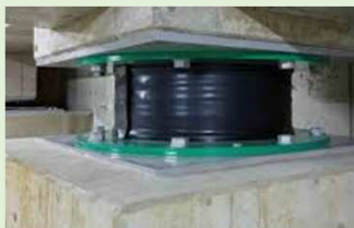
震度7に耐える免震システムの採用
